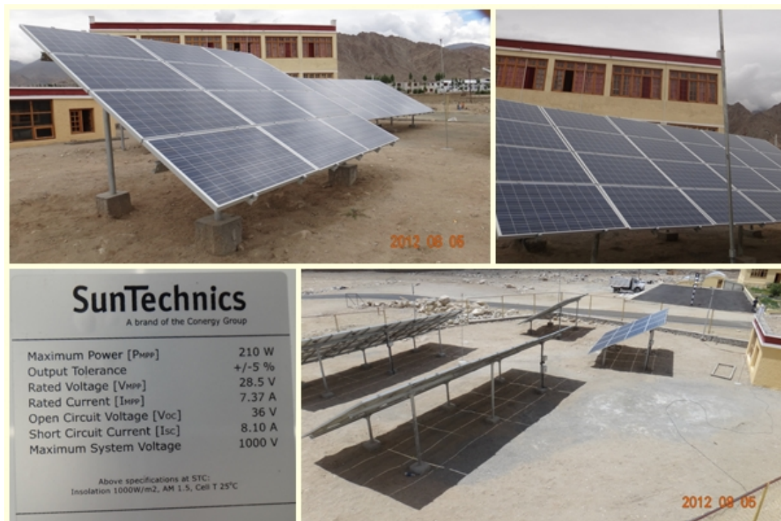
Jamyang School 的 15kW 太陽能發電系統之太陽能面板
