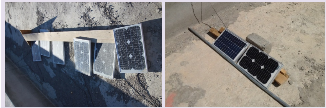
滑落的太陽能板(左)，已修復的太陽能支架(右)
