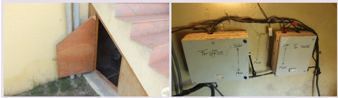
電力控制室入口(左)，太陽能與市電的轉換開關(右)
